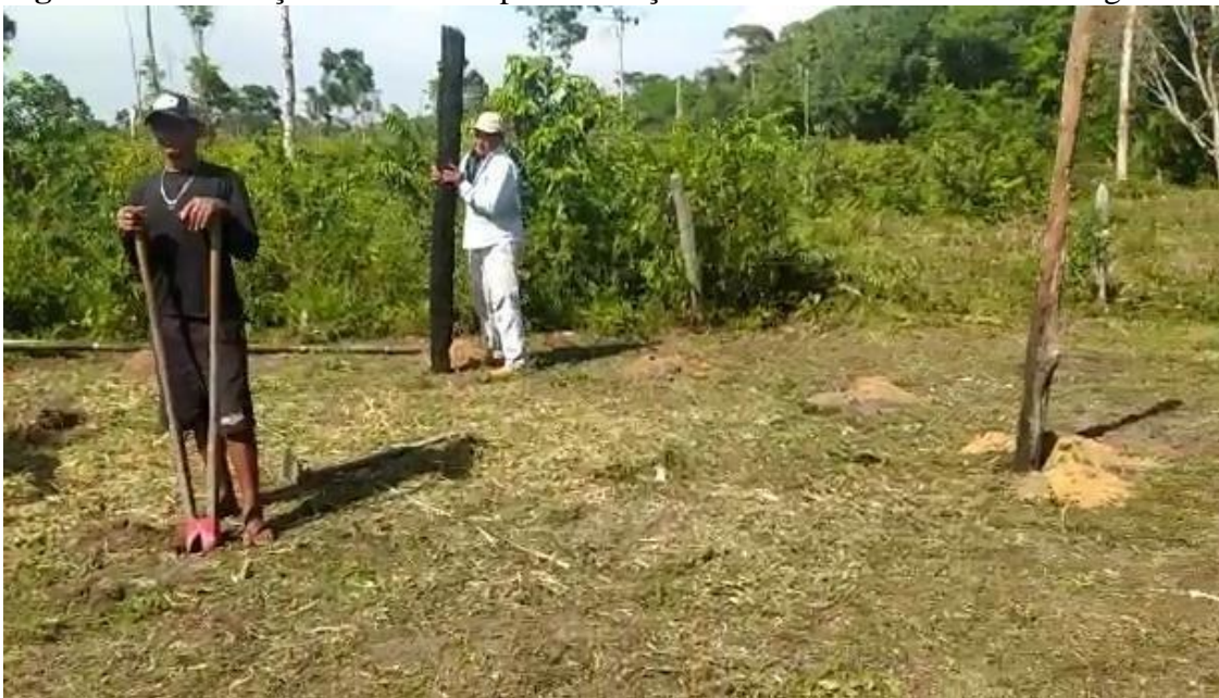
Figura 01 - Escavação dos buracos para a fixação das estacas e o cano de drenagem.
