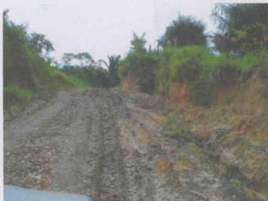
Figura 52 – Condições de algumas estradas
