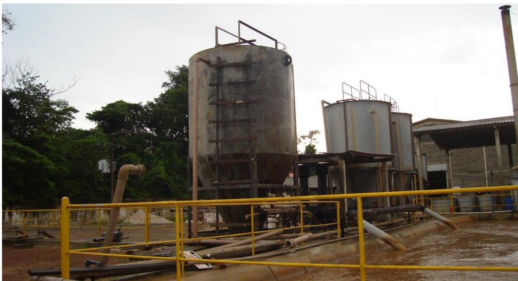
Figura 6. Aspecto da Estação de Tratamento de Esgoto do curtume A (Foto: Idemê Amaral).
